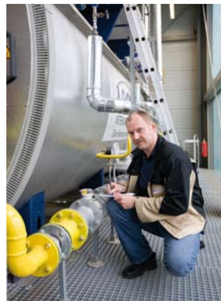
Energie-Ingenieur Thorsten Lüth kontrolliert Verbrauchswerte an einem Dampfkessel im Kraftwerk
